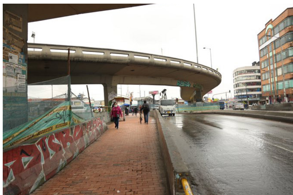
El puente actual tiene más de 40 años de construcción y no cuenta con las condiciones técnicas requeridas para soportar el tránsito de vehículos particulares y de buses de TransMilenio.
